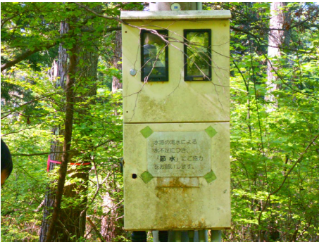
⑯分電盤周り
