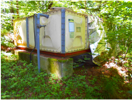
⑧受水槽周り
