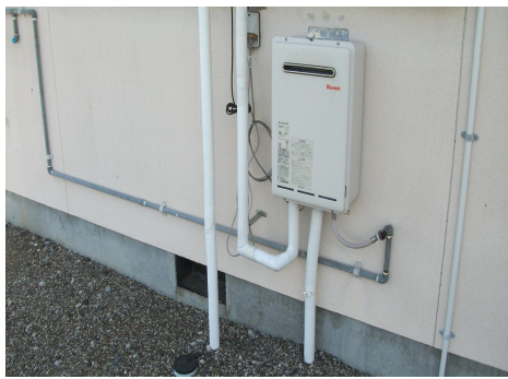
⑧給湯器廻り
