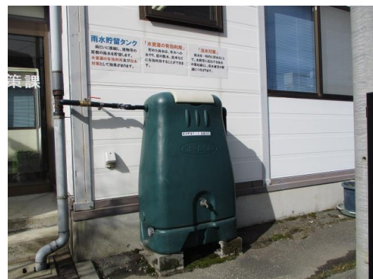
▲旧市役所環境課に設置した 雨水貯留タンク（モデル施設）
