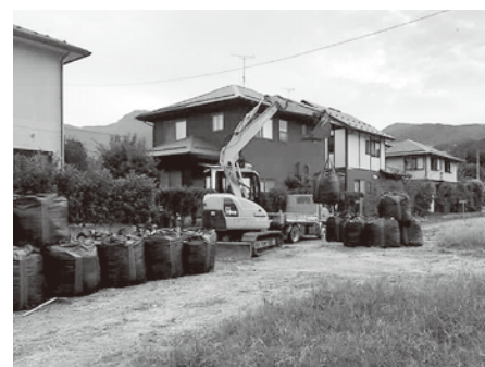
▲大型土のう設置後、若宮用水の内水氾濫対策が必要な八幡代団地
