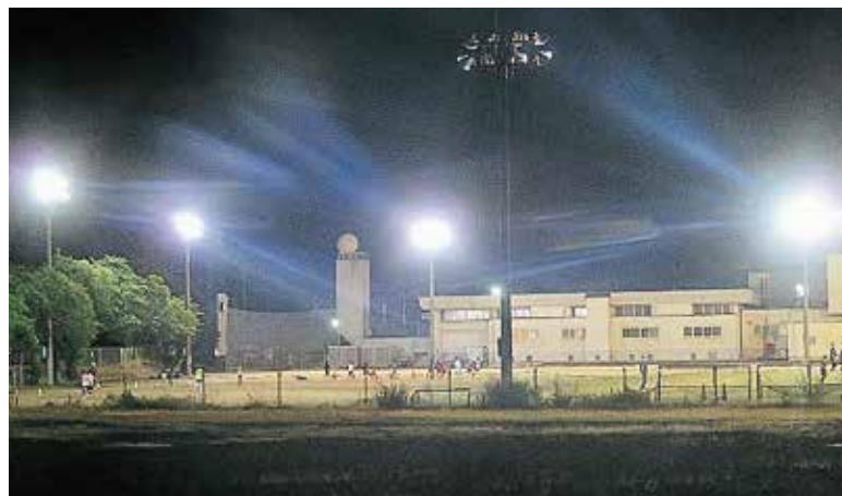
現在の戸倉体育館Aグラウンドの照明
