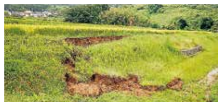
八幡地区 農地の法面崩落
