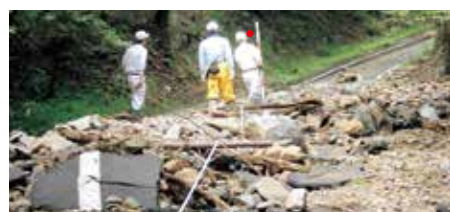
八幡地区 林道の地割れ
