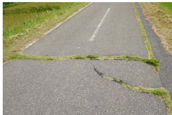
【舗装の劣化状況】
