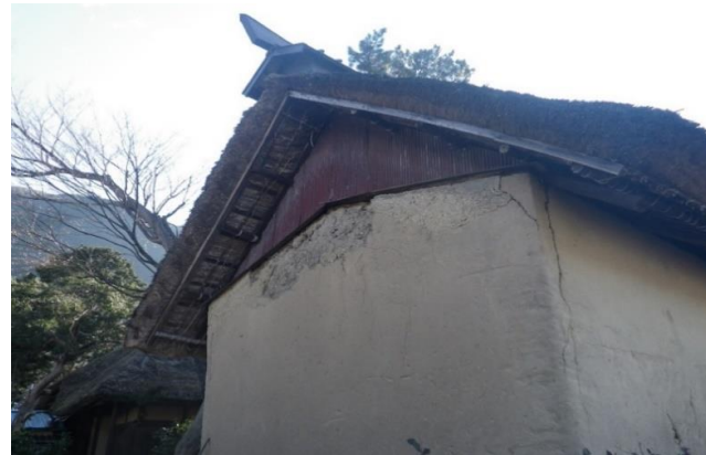
壁の表面が剥がれ落ちた登録有形文化財の瀧澤家住宅(磯部)
