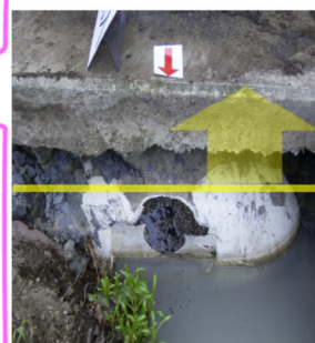
流入管は溜まった汚水の下 ↑
