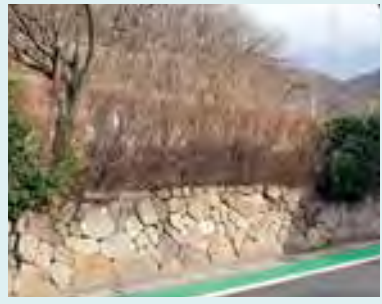
寂蒔水除土堤
