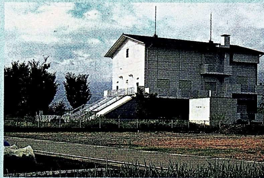
尾米川排水ポンプ場
