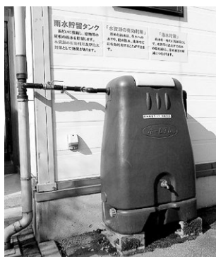
旧更埴庁舎環境課に設置した雨水貯留タンク（モデル施設）
