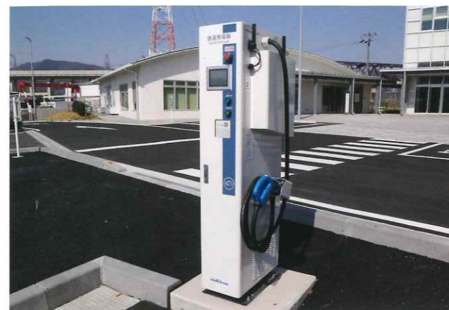
電気自動車用充電設備
