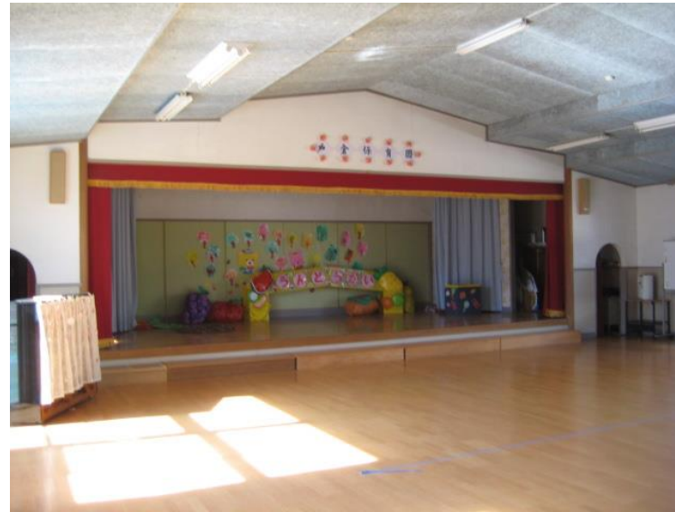
冷房がない遊戯室
