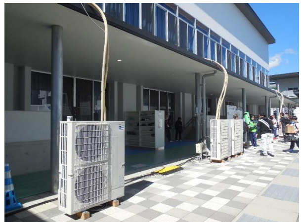
仮設エアコンの室外機
