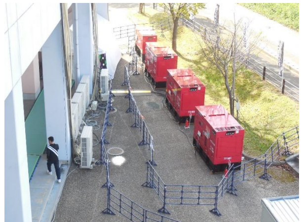
暑さ対策としてアリーナに設置されたエアコン用の発電機
