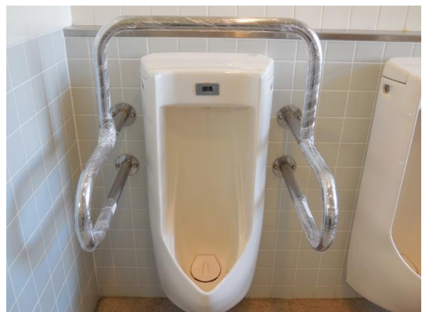
松やに対策(男性トイレの手すり)
